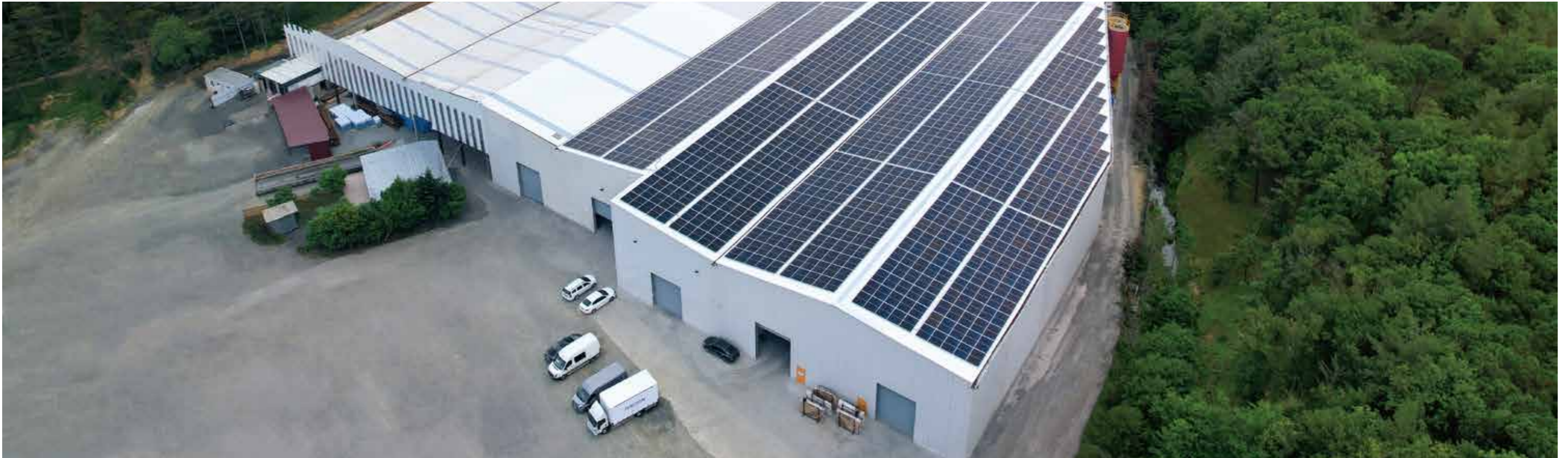
04 Snížení nákladů na energii - stáčárna minerální vody Turecko, 900kW KSG-120CL-M0
